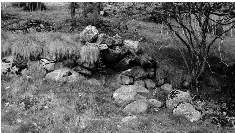
Der Eigentümer der Mauer haftet für den Schaden, den herausfallende Steine allfällig verursachen.
