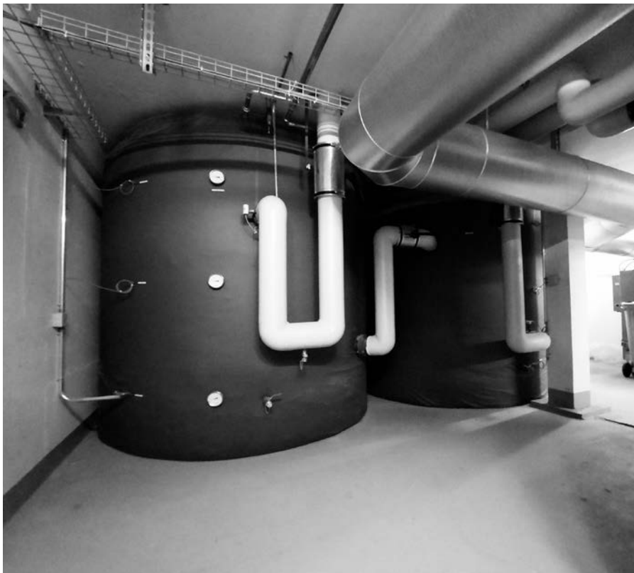
Die beiden neuen Heizwasser Speicher in der Zentrale weisen ein Fassungsvermögen von 12'500 Liter auf.
