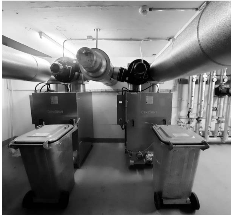
Blick in die Zentrale: Im Hintergrund die beiden neuen Holzschnittel Öfen mit einer im Vergleich zu früher doppelt so hohen Leistung von total 480 kW.
